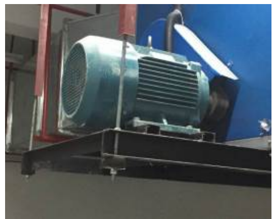
项目风机减震
