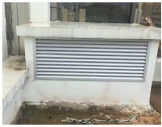
发电机废气排放口
