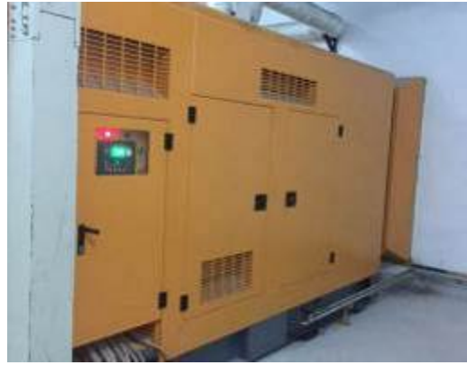
项目备用发电机隔音箱
